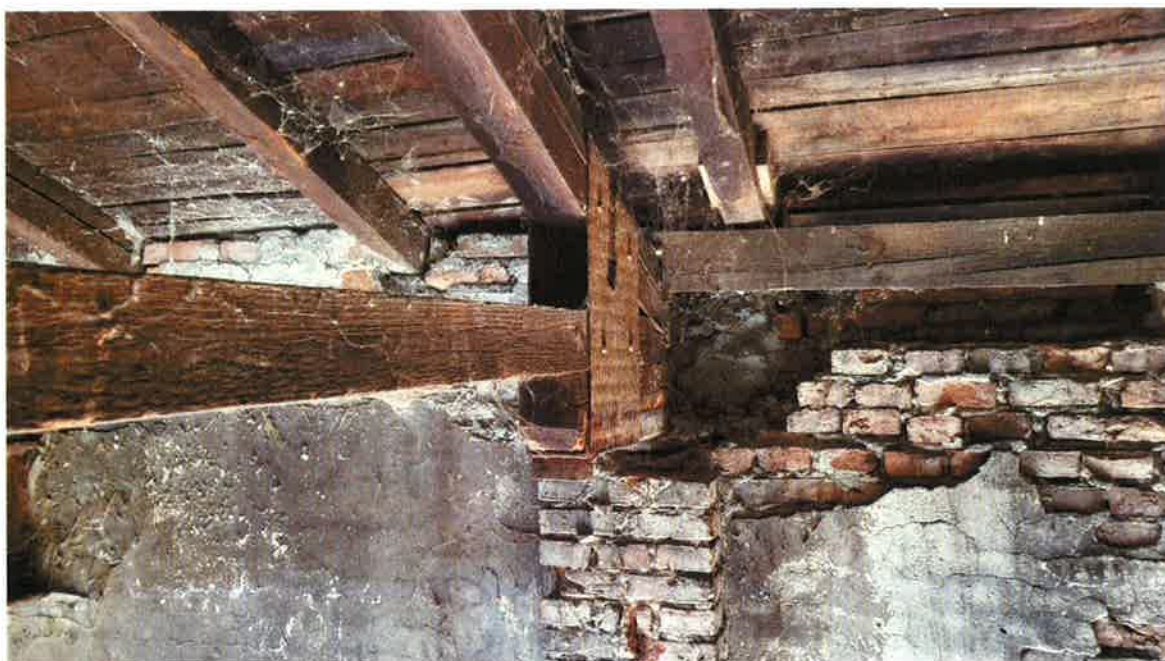
10. střecha - provedené zesílení v uložení, napadené hnilobou
