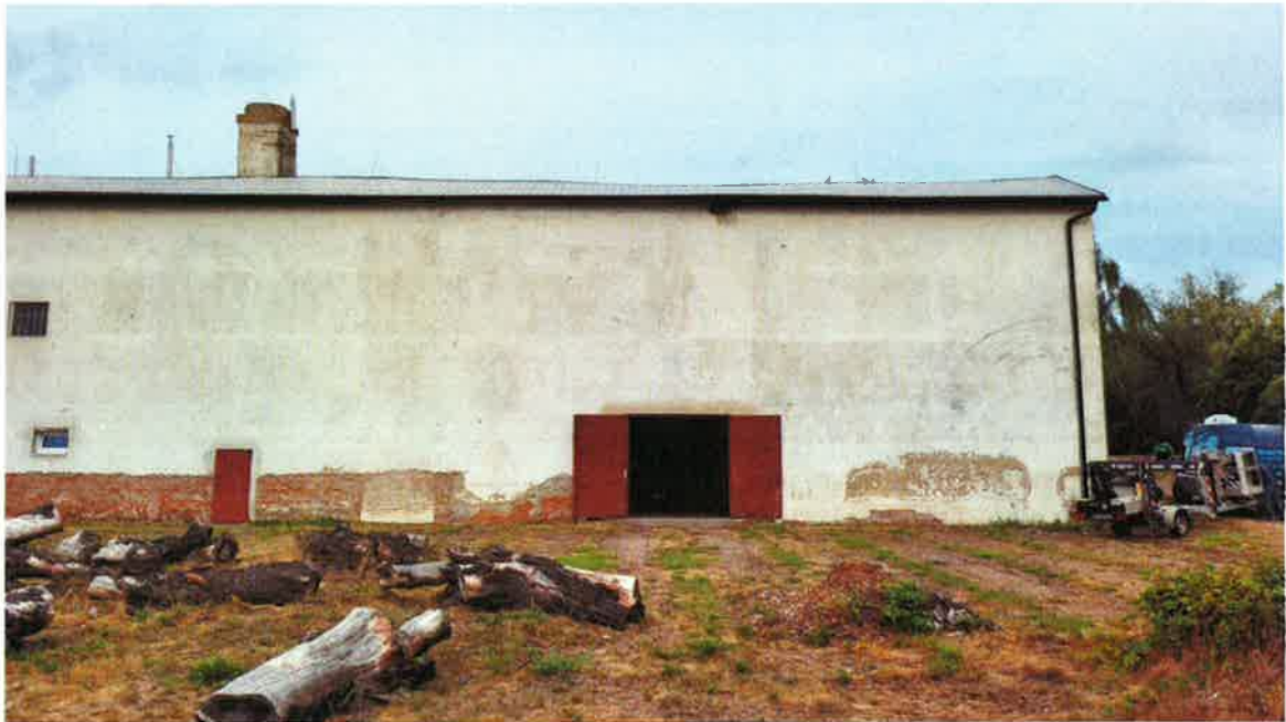
7. střecha – deformace hřebene
