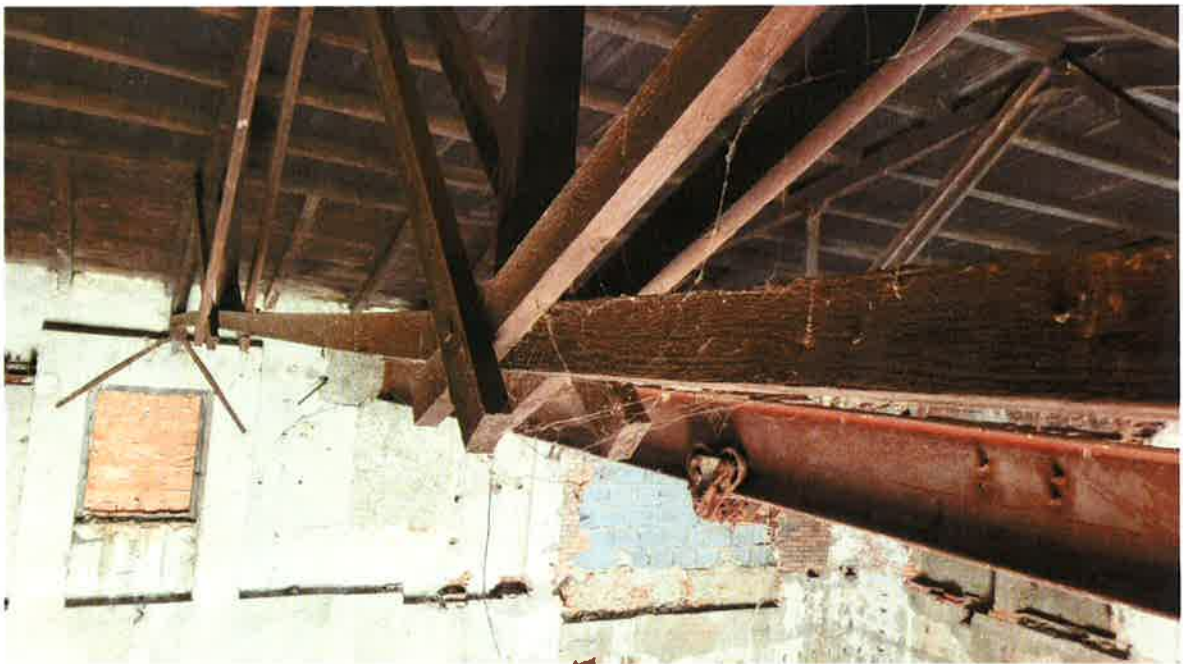
8. střecha – zvlnění spodního pasu, detail spojů vazníků
