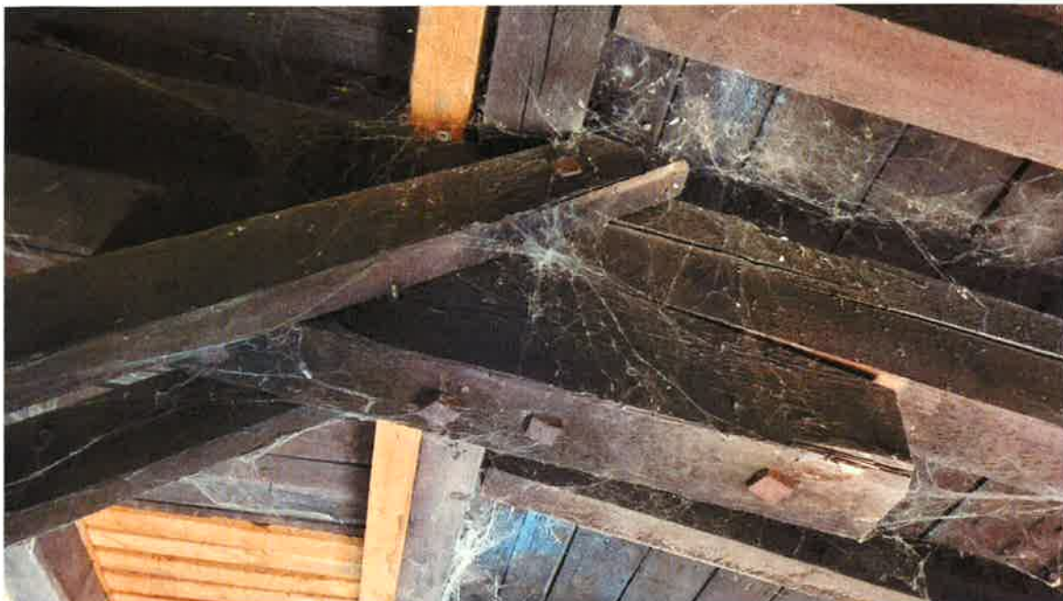
11. střecha - rozevření spoje v lomu horní pásnice vlivem deformace vazníku:
