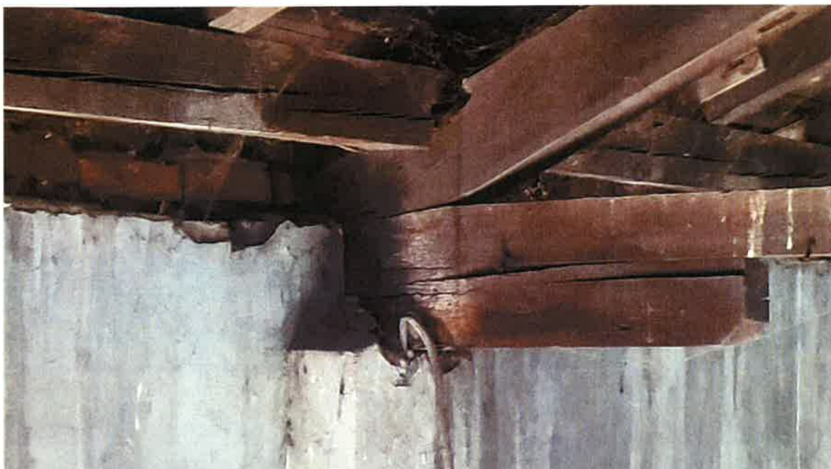
9. střecha - poškození hnilobou v místě uložení vazníků
